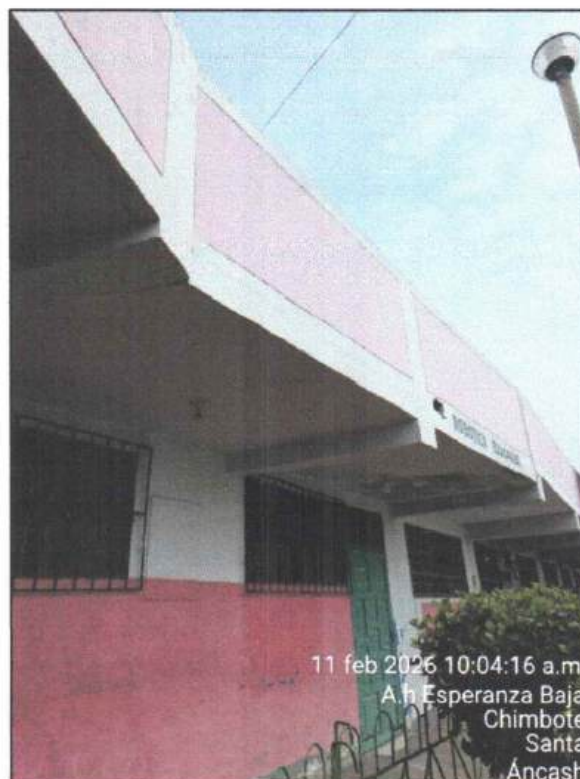
Fotografía N°05: se verifica que en dicha aula hay presencia de rajaduras en elementos estructurales y no estructurales.
