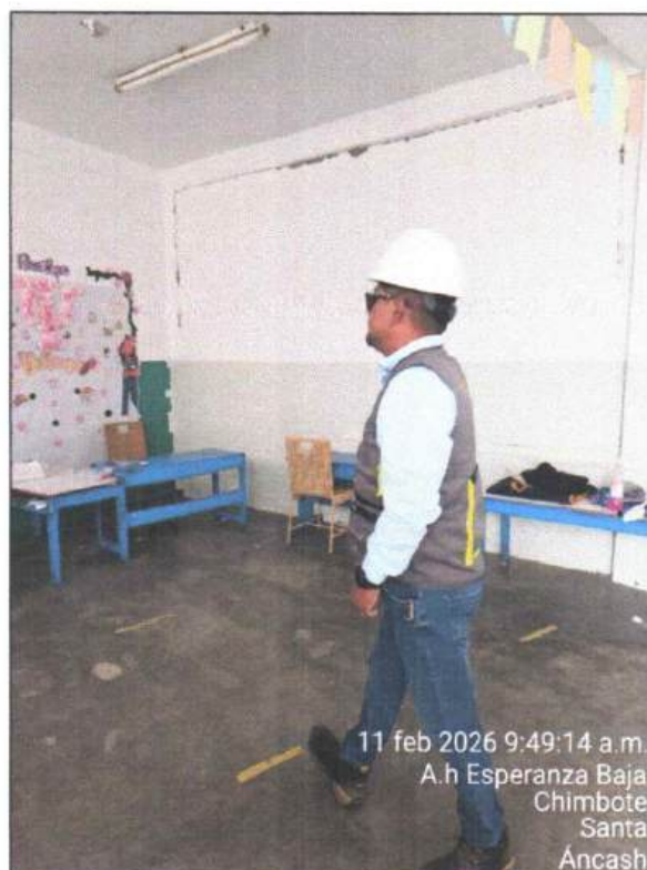
Fotografía N°06: se verifica que en dicha aula hay presencia de rajaduras en elementos estructurales y no estructurales.
