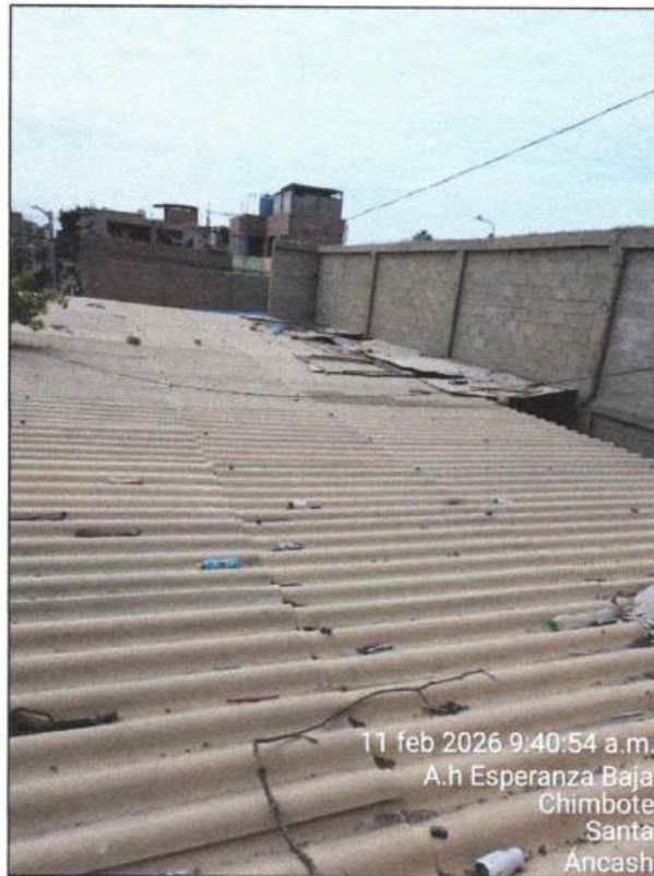
Fotografía N°08: se observa que la cobertura de aulas del segundo nivel está en pésimo estado de conservación.
