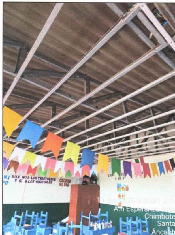
Fotografía N°09: se observa que la cobertura de aulas del segundo nivel está en pésimo estado de conservación y no cuenta con las baldosas de protección en cielorrasos.
