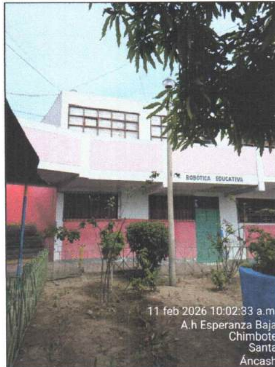
Fotografía N°04: escalera de acceso al segundo nivel donde se aprecia la construcción de un aula de dos niveles el cual se ejecutó sin control técnico de profesionales.
