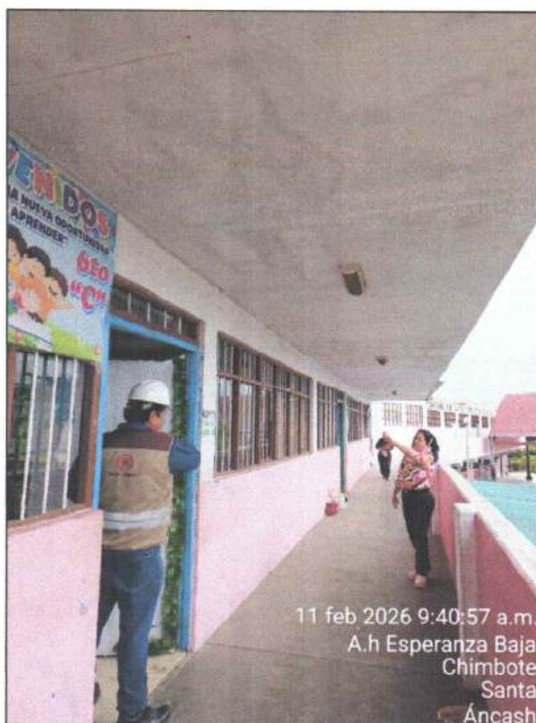
Fotografía N°07: se observa fisuramiento en losa aligerada.
