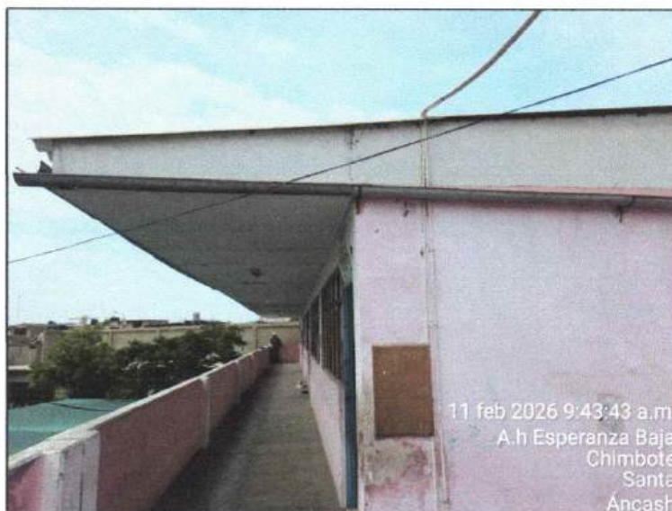
Fotografía N°12: sistema de canaletas de drenaje pluvial en mal estado de conservación.
