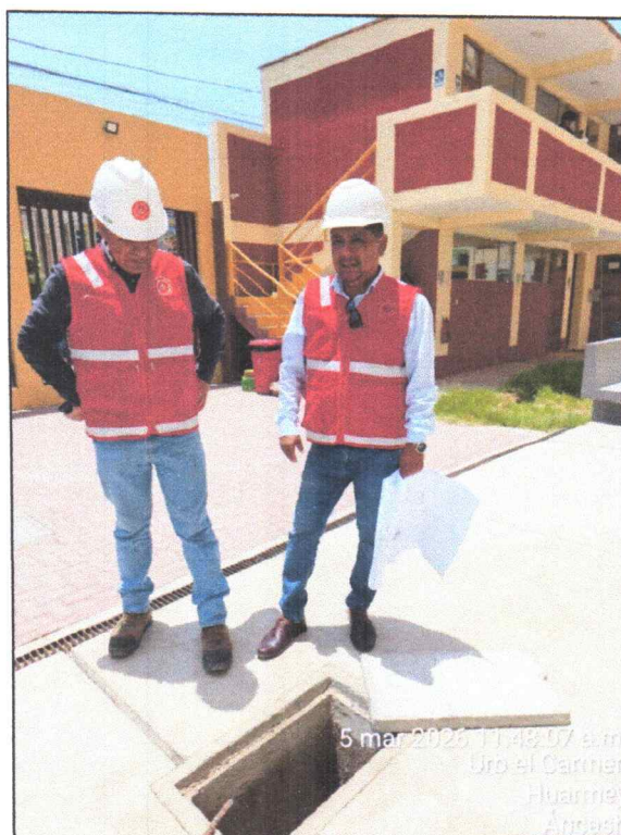
Fotografía N°27: Inspección de tapas de cajas del sistema de desagüe y se observa que están con presencia de agua estancada debido a una contrapendiente que no permite su circulación.
