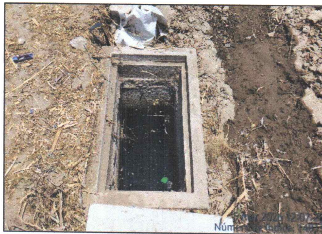
Fotografía N°34: Inspección de tapas de cajas del sistema de desagüe con presencia de agua estancada lo que dificulta la circulación a la red pública.
