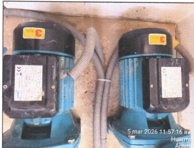
Fotografía N°09: Instalación de equipos eléctricos en tanque elevado los cuales no cumplieron con el periodo de garantía y tuvieron que hacerles mantenimiento correctivo.
