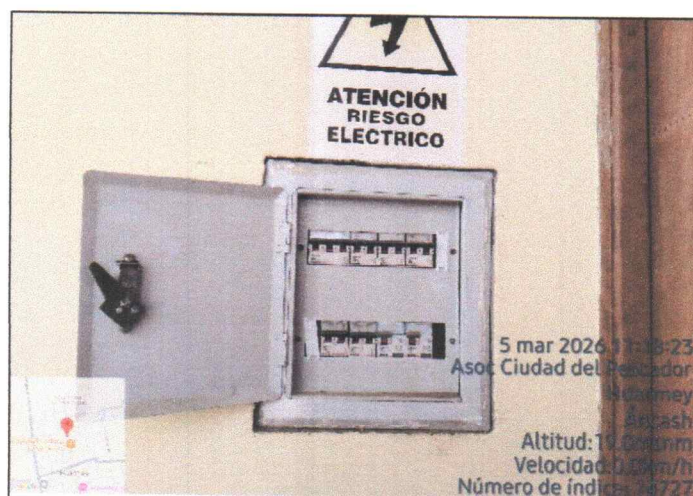
Fotografía N°04: Inspección de tableros y sub tableros eléctricos y en donde se observa que los circuitos existentes no cuentan con leyenda, lo que dificulta la verificación.
