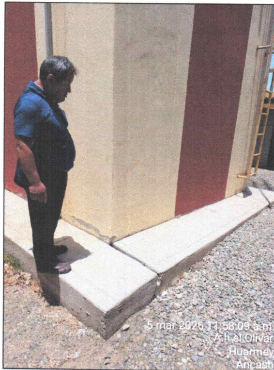
Fotografía N°14: Presencia de asentamiento de vereda perimetral en los exteriores de la caseta del tanque elevado, posible falla por mala compactación de la base.
