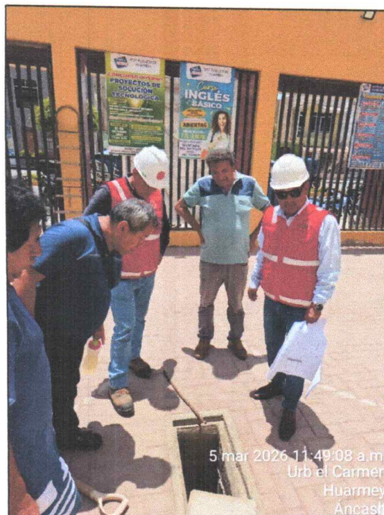
Fotografía N°29: Inspección de punto final de evacuación de desagüe a la red pública y se observa estancamiento de agua debido a la falta de pendiente.
