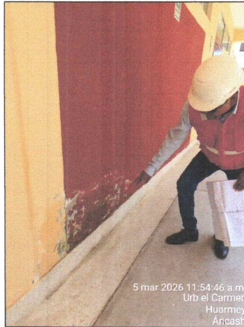
Fotografía N°40: Presencia de filtraciones en muros exteriores a los servicios higiénicos.
