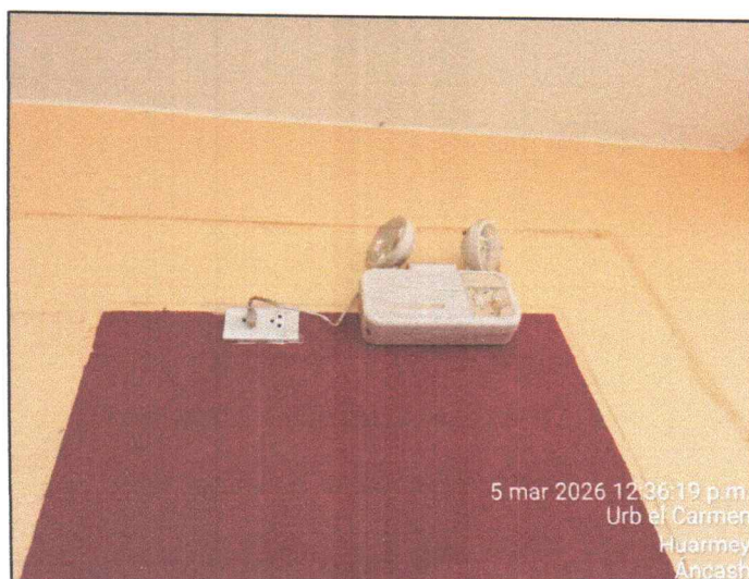
Fotografía N°05: Verificación de luces de seguridad no operativas y de mala calidad.
