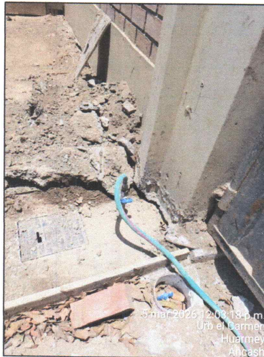
Fotografía N°20: Instalación de agua alterna y no adecuada de manera provisional, dicha instalación está ubicada por el otro ingreso lateral al IESTP Huarmey.
