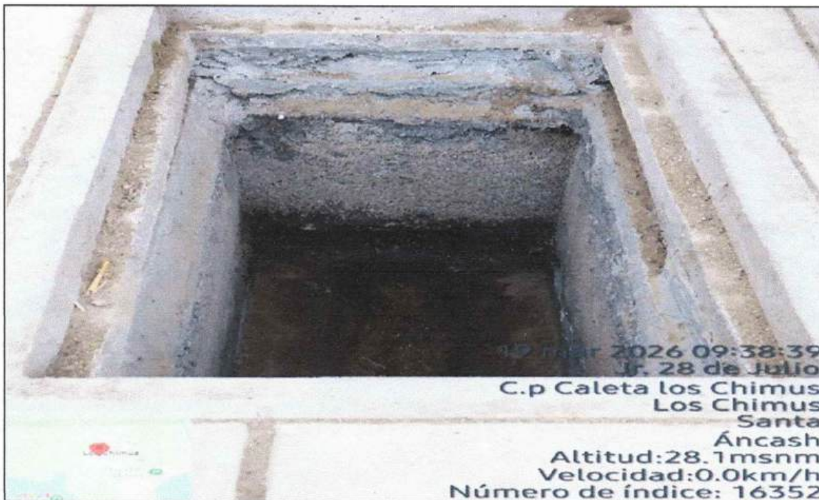
Fotografías N°13 y N°14: Fisura generada en contorno de caja exterior
