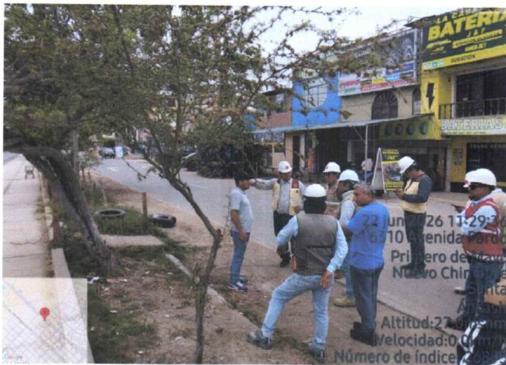
Fotografía N°09: En los sardineles y muros de contención en su mayoría tienen problemas de carbonatación y corrosión.
