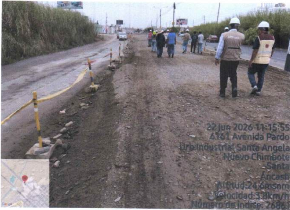
Fotografía N°04: Se aprecia la pendiente del pavimento, formando en su punto medio una curva vertical.
