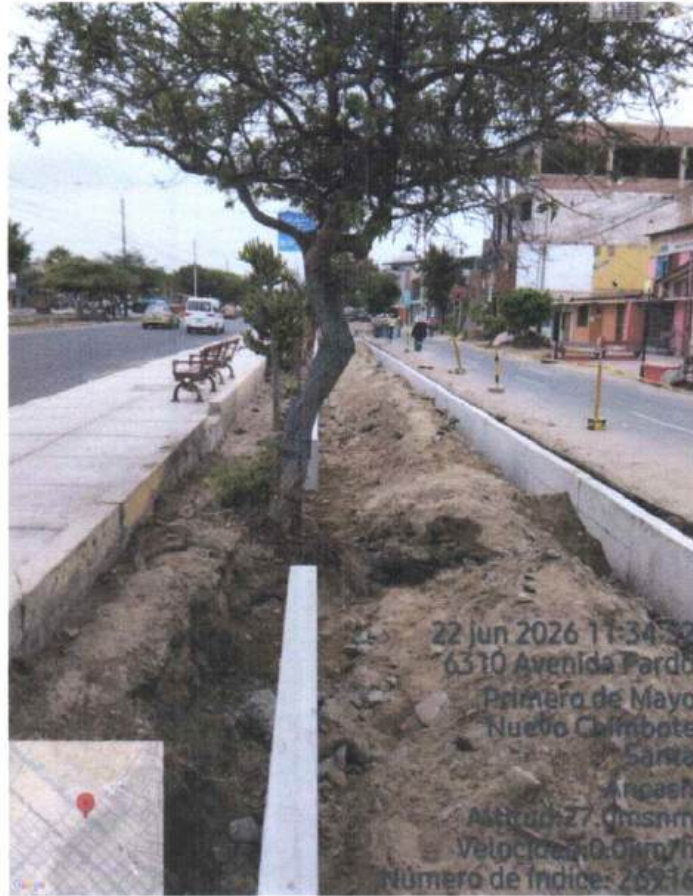
Fotografía N°10: Se debe retirar los árboles ubicados en zonas de Ciclovía.
