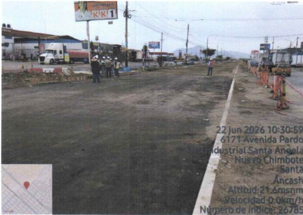
Fotografía N°03: Verificación de los probables desbordes y afectación de la carpeta asfáltica
