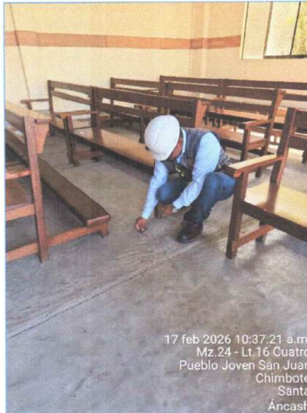
Fotografía N°13: vista de fisuras en pisos en ambiente destinado como contingencia de la parroquia.
