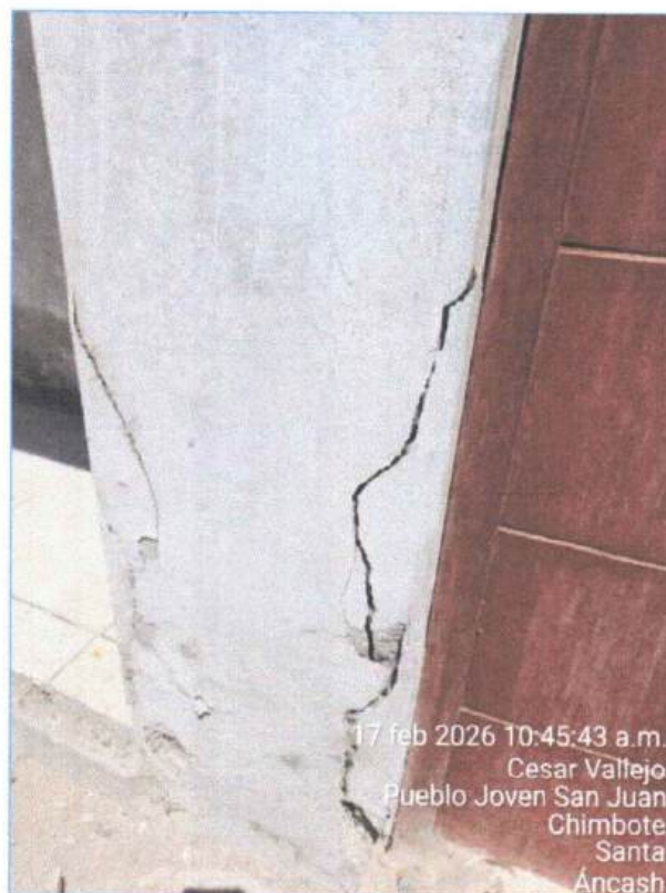
Fotografía N°15: se observa rajaduras en base de columnas de los servicios higiénicos y en algunos casos se observó corrosión del acero de refuerzo.
