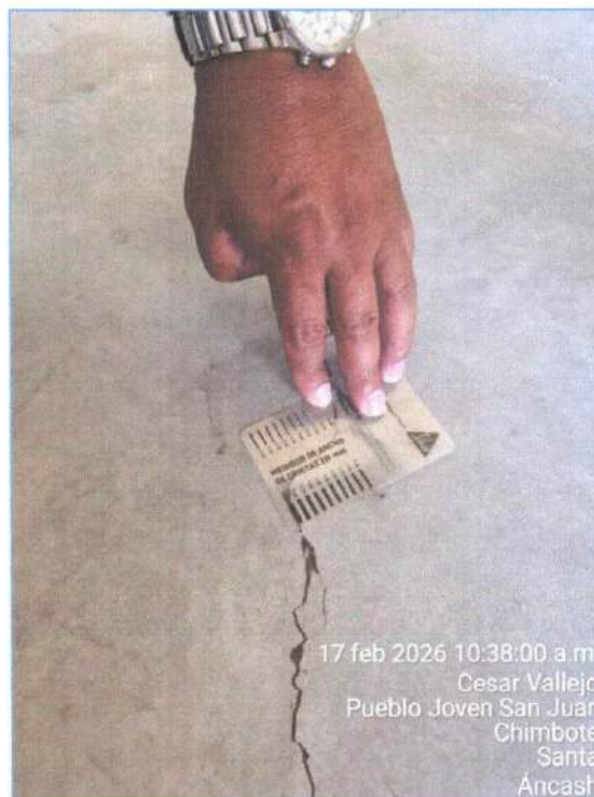
Fotografía N°14: con ayuda de la plantilla de fisurometria se observa presencia rajaduras de 1 a 4 mm en pisos.
