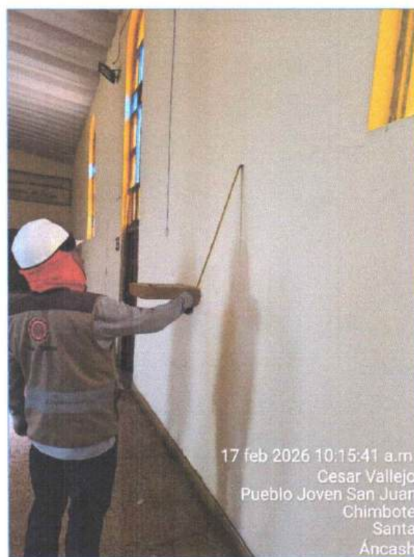
Fotografía N°10: vista de muro con presencia de fisura en el vano de ventana a través de la junta de dilatación.
