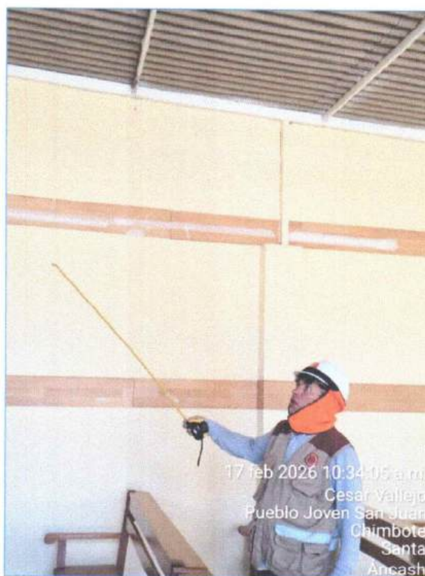
Fotografía N°16: se observa que la cobertura no cuenta con un sistema de tijeral como soporte.
