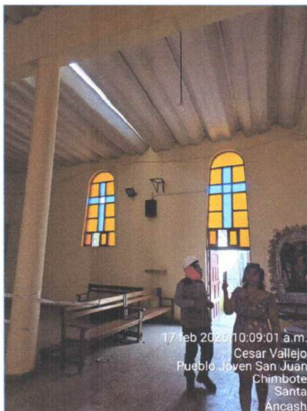
Fotografía N°07: vista interna de la parroquia el cual sufrió desprendimiento de tarrajeo, así como también desprendimiento de la cobertura tipo canalón.
