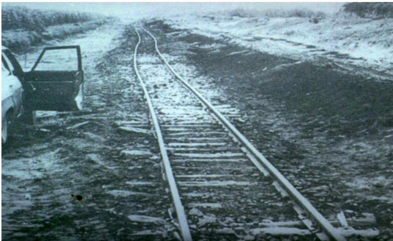
Fig.10. Vía férrea Chimbote - Huallanca, desplazamientos por fallas en el suelo.
