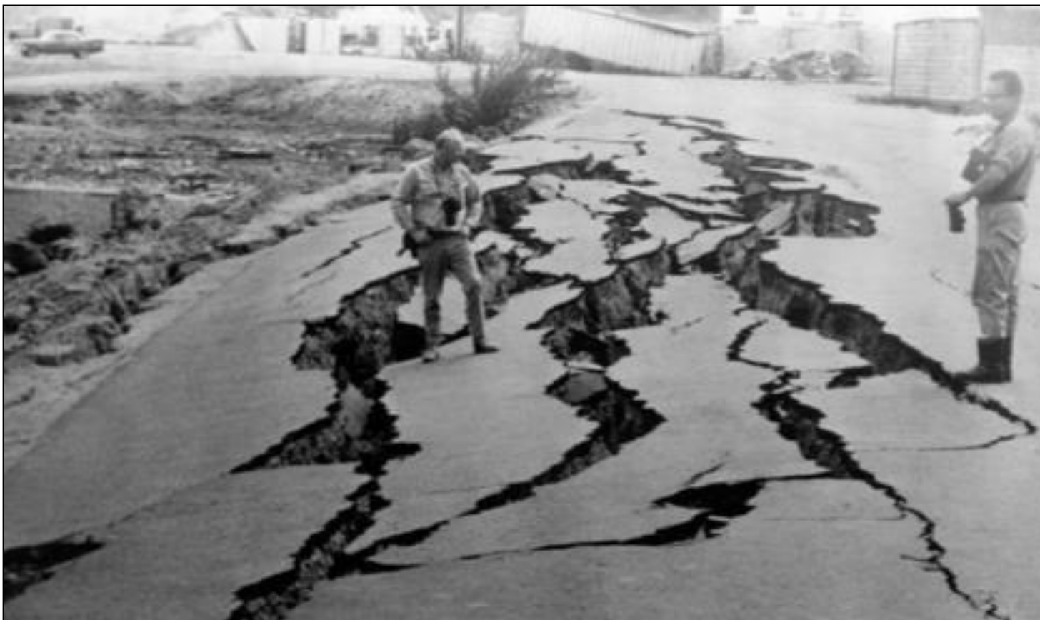
Fig.5. Falla de plataforma de carretera, por licuefacción
