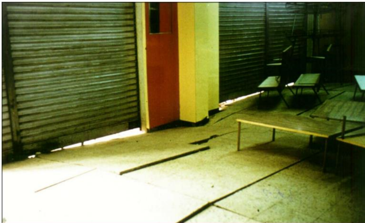
Fig.8. Agrietamiento de pavimentos y cimentaciones por compactación diferencial en el centro de Chimbote
