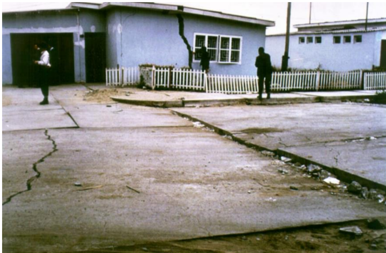
Fig.7. Casa de bloques concreto afectada por compactación diferencial y desplazamiento lateral de arena de playa licuada - Chimbote
