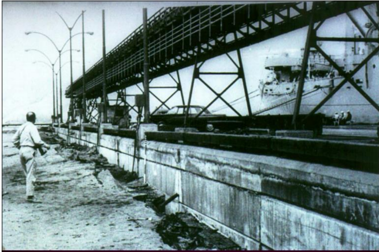
Fig.11. Subsistencia de relleno adyacente a muelle de planta de acero debido a compactación y desplazamiento lateral del terreno. El muelle estaba cimentada sobre pilotes profundos de concreto
